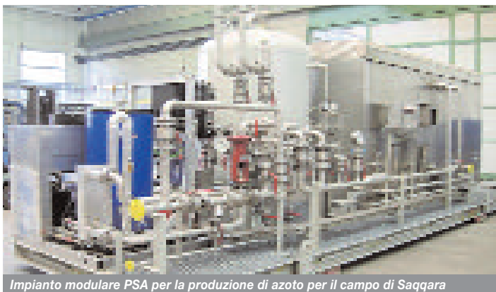
Impianto modulare PSA per la produzione di azoto per il campo di Saqqara
