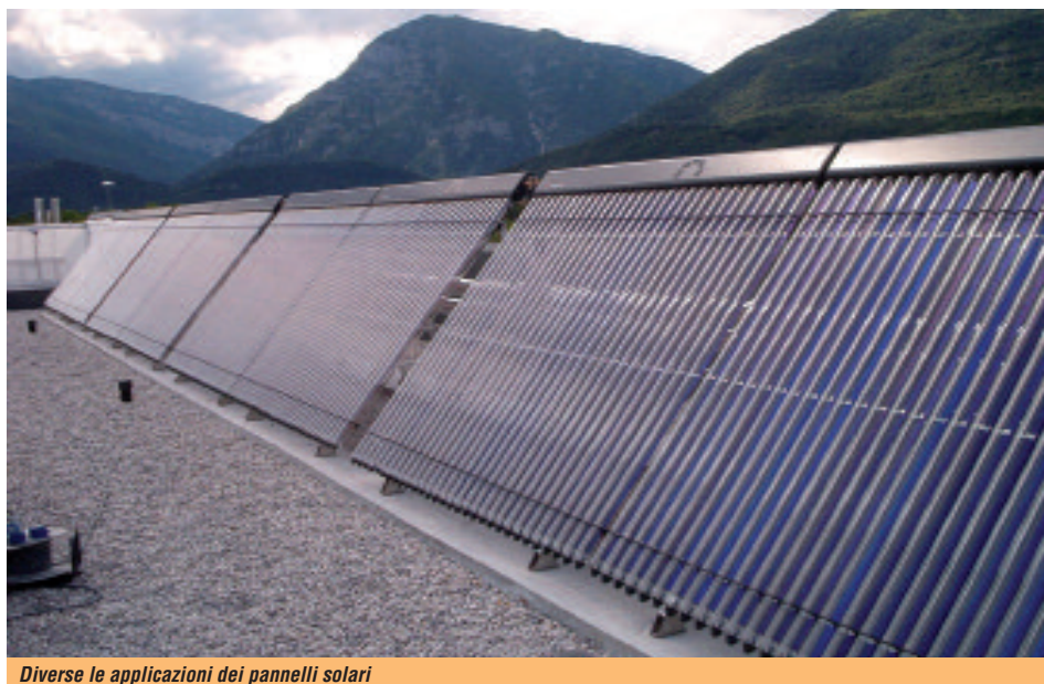
Diverse le applicazioni dei pannelli solari
