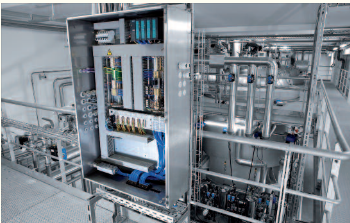
Gli armadi di comando strutturati in modo uguale facilitano diagnostica e manutenzione
