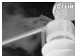
Perdita di gas SF 6
