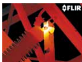
Connessione difettosa ad alta tensione
