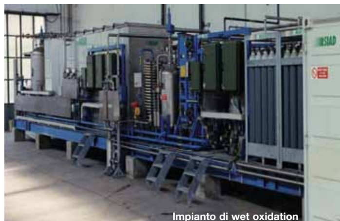
Impianto di wet oxidation
