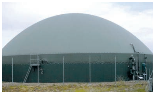
Fig. 1 Cupola gasometrica integrata nel digestore anaerobico
