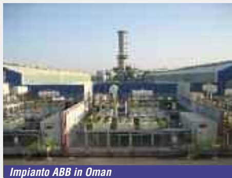
Impianto ABB in Oman
