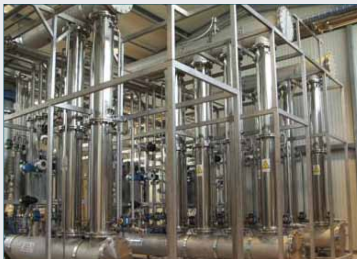
Fig. 2 - PVClean impianto di ultrafiltrazione
